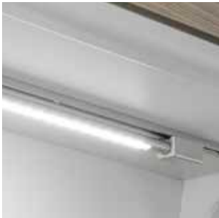
Energieeffiziente LED-Beleuchtung im Innenraum.
