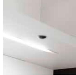
Energieffektiv LED- belysning i bodelen.
