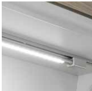
Energieffektiv LED- belysning i interiören.
